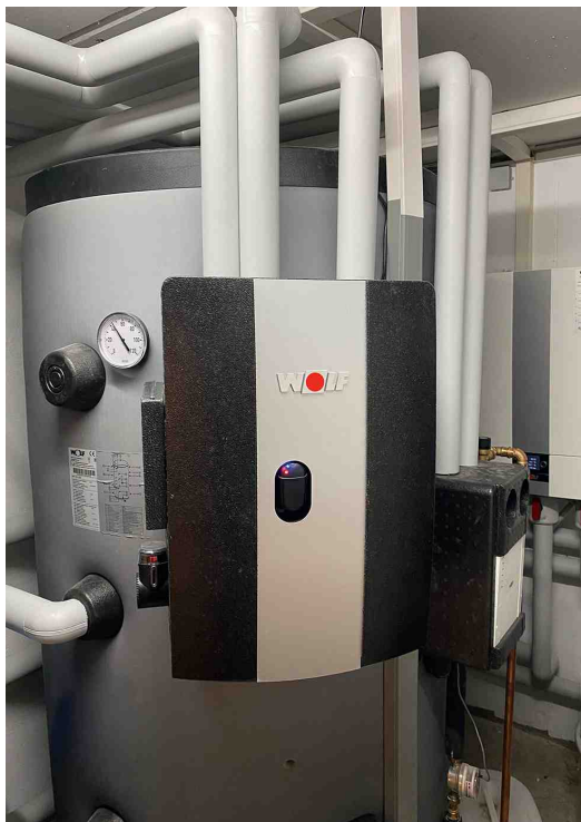
Ein Pufferspeicher ermöglicht eine optimale Installation in der Sanierung sowie eine einfache Einbindung weiterer Wärmequellen.
