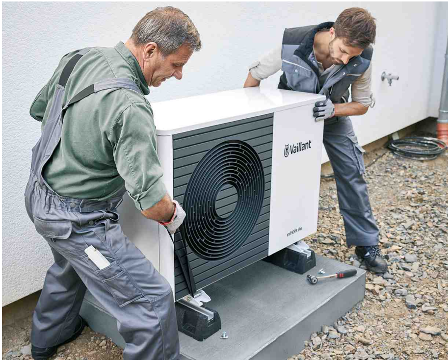
Bild 4: Wärmepumpen werden meist in Kombination mit Fußbodenheizungen installiert. Damit ist auch ein Kühlbetrieb möglich. Bild: Vaillant
