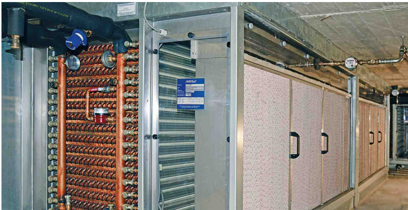
Freie Aufstellung einer adiabatischen Verdunstungskühlung. Die Luft strömt von rechts kommend durch den Wabenbefeuchter.
