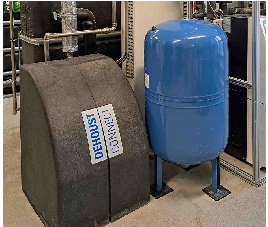
Mit Dehoust „Connect“ kann der Installateur auf die Anlagendaten zugreifen und diese – auch ortsunabhängig – anpassen. Bild: Dehoust
