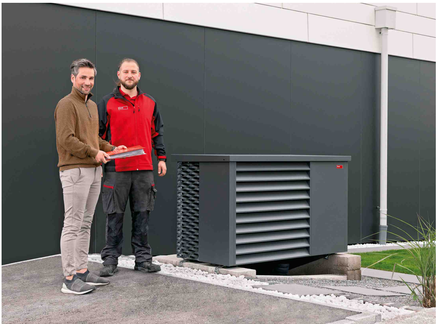
Andreas Thaller bei der Inbetriebnahme der Luftwärmepumpe Belaria® pro compact von Hoval.
