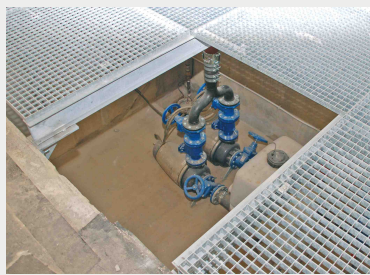
Abwasserschacht mit Grundfos Hebeanlage MDV mit 400-Liter-Sammelbehälter für zuverlässige Entwässerung auch bei großen Zulaufmengen. Bild: Jochen Krings
