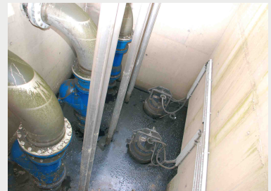
Pumpenschacht mit Grundfos S2 Tauchmotorpumpen für unter der Rückstauenebene anfallendes Regenwasser von Fahrstraßen und Rampen. Bild: Jochen Krings
