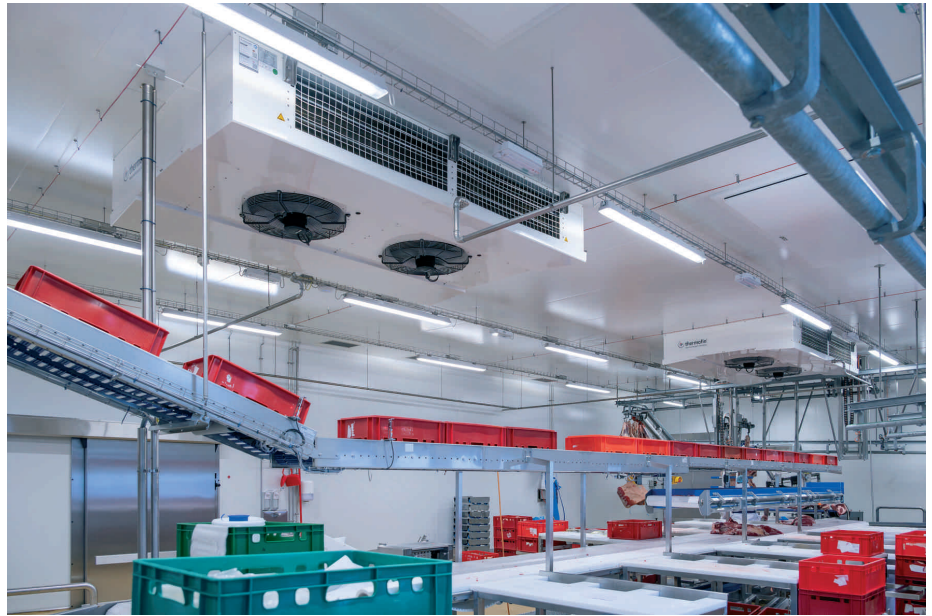
In der Fleischverarbeitung schafft die Hauser Kälteanlage eine besonders gleichmäßige Kühlung. Bild: Hauser
