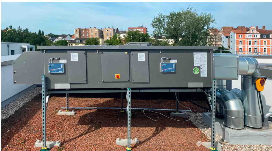
Auf dem Dach sind zwei „DUPLEX 1500 Multi Eco-N“-Geräte installiert. Sie versorgen 24 Wohneinheiten im Quartier Ohe-Höfe in Hannover. Bild: Airflow Lufttechnik.
