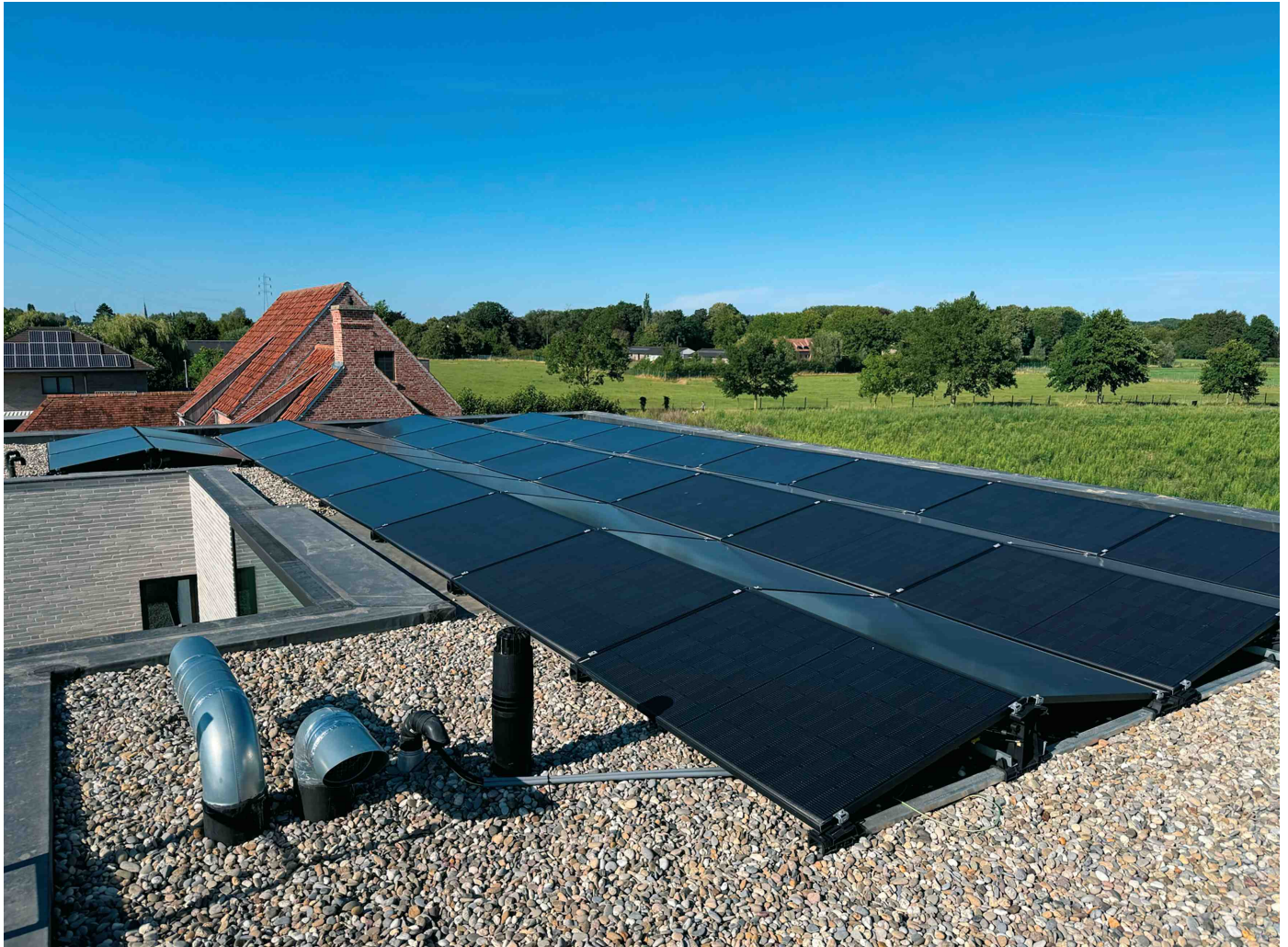
Auf dem Flachdach der Neubau-Villa wurde ein 36 kWp Photovoltaiksystem mit Ost-/West-Ausrichtung installiert.
