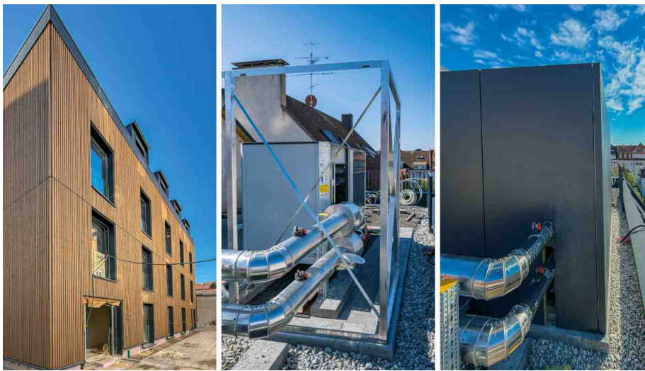
Auf dem Dach dieses Münchener Hotels steht ein Kaltwassererzeuger. Eine eSilent Einhausung von ATEC, Wahlfarbe RAL7016, dämpft nun sein Betriebsgeräusch.
